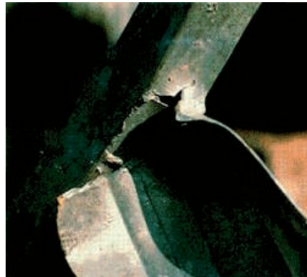
Abb. 10: Konstruktion aus Rechteckhohlprofilen, die im Zinkbad als Folge fehlender Bohrungen auseinander gerissen wurde
