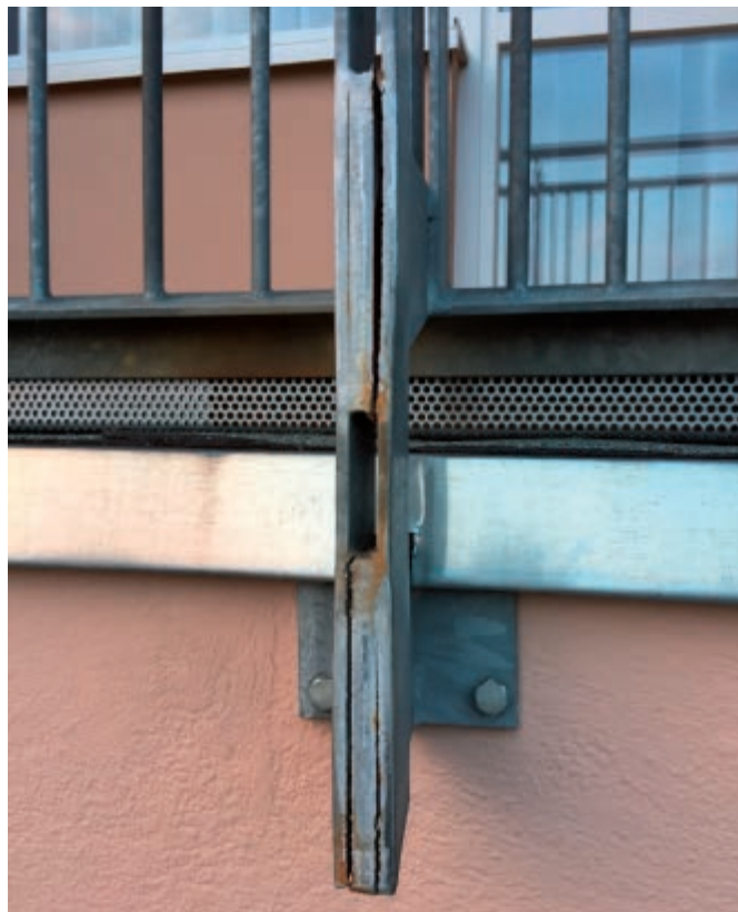
Schaden an einem feuerverzinkten Geländerpfosten mit nur teilweise verschweissten Überlappungen
